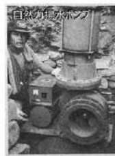
▲ポンプへの4mの落差で約200mを揚水可能
